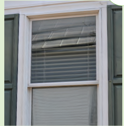
Las ventanas de vinilo no son apropiadas para las estructuras Contribuyentes y Emblemáticas.
